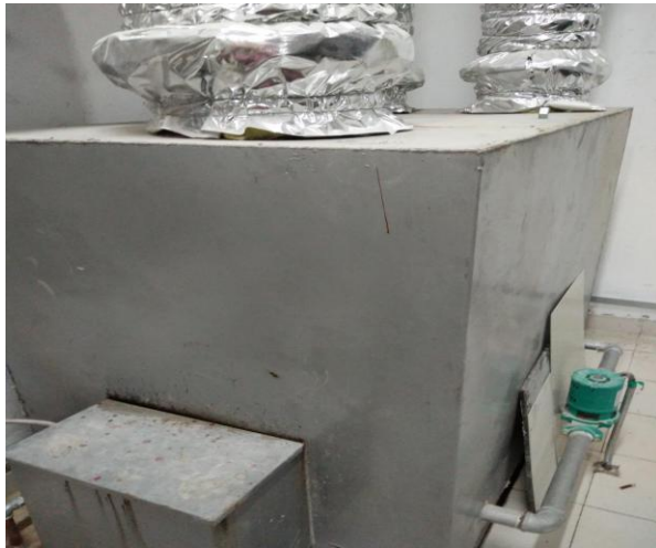
发电机尾气水喷淋装置
