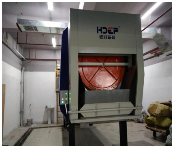
新大楼生活垃圾收集装置（位于-1F 南面）
