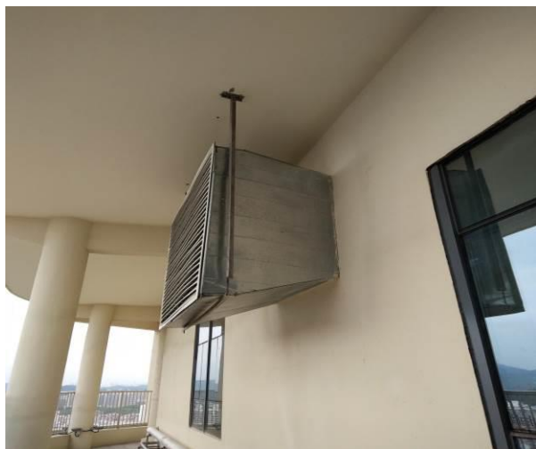
发电机尾气排放口（位于新大楼楼顶西北侧）
