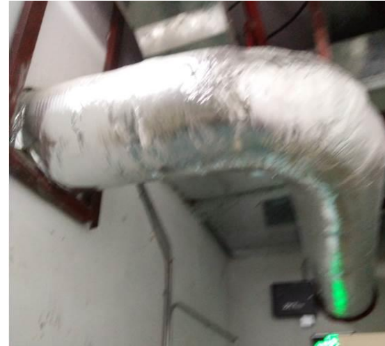
发电机尾气专用排放管道
