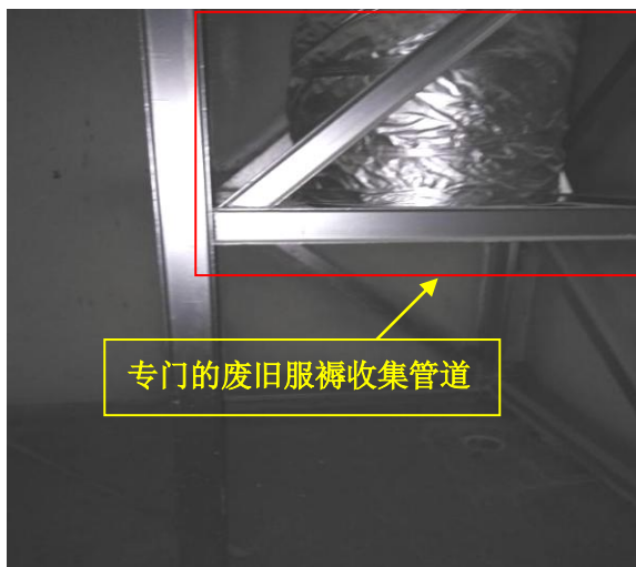
新大楼废旧服褥收集管道及收集房（位于-1F 南面）
