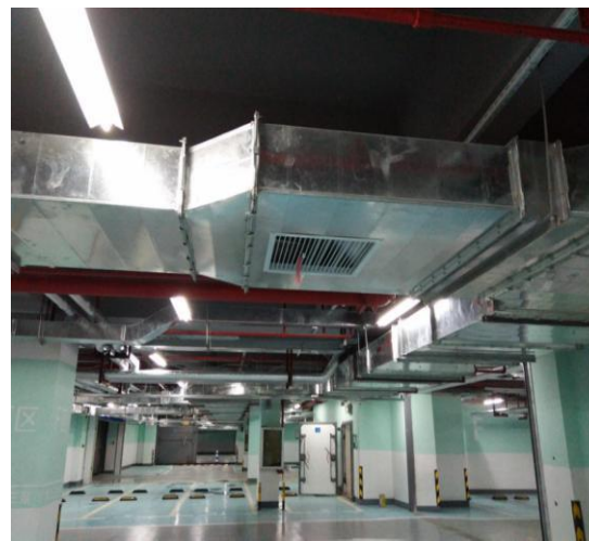
地下室停车场通排风
