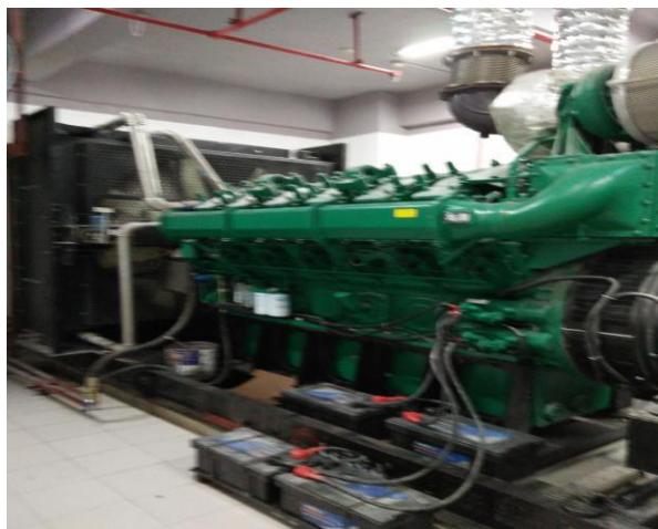
项目备用发电机（位于-2F 南侧）
